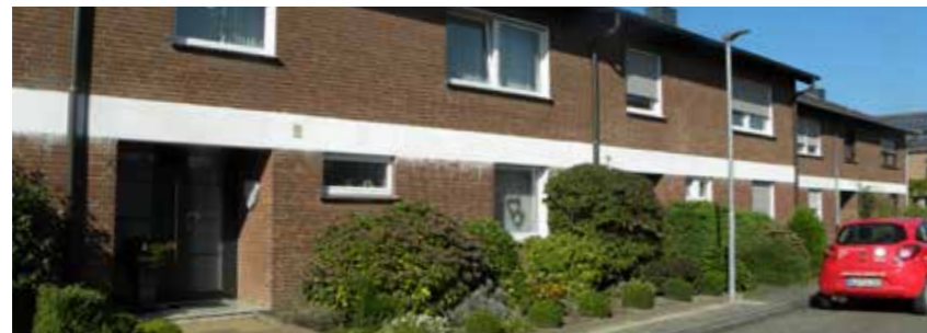
Einsatz unterschiedlicher Materialien in den Fassaden in der Vogelsiedlung Straelen. Unterschiedlich verwendete Materialien können unterschiedlich gut Wärme leiten und dadurch eine Wärmebrücke bilden und zum Energieverlust führen.
