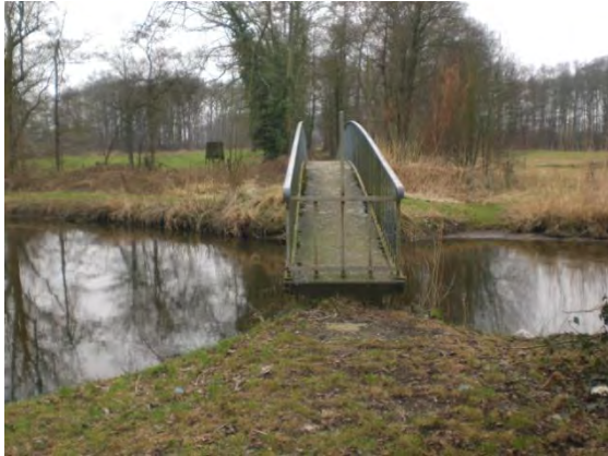
Foto 81 gesperrte Niersbrücke zwischen Straethof und Klaesenhof
